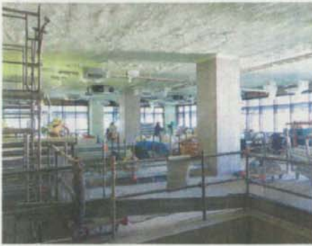
住宅階との切り替え階では天井に断熱材を塗布している
